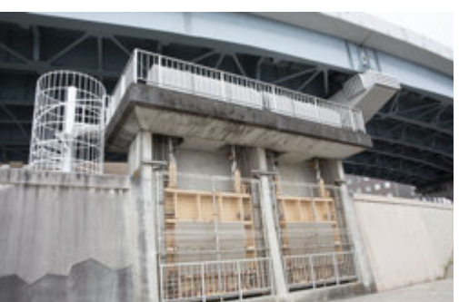
浸水被害からまちを守る浜町ポンプ所の放流ゲート
